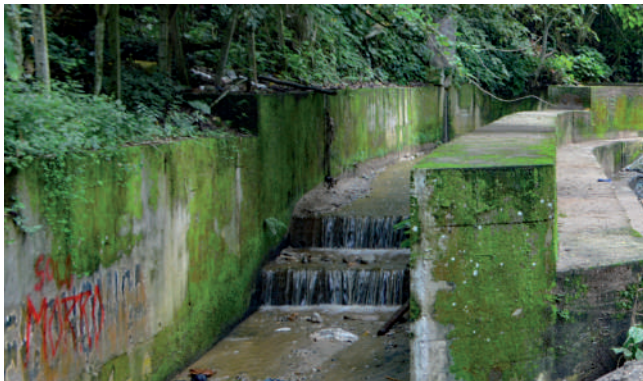
Canalización en mal estado Quebrada las Mojarras.
